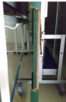
横から見た破損状況
